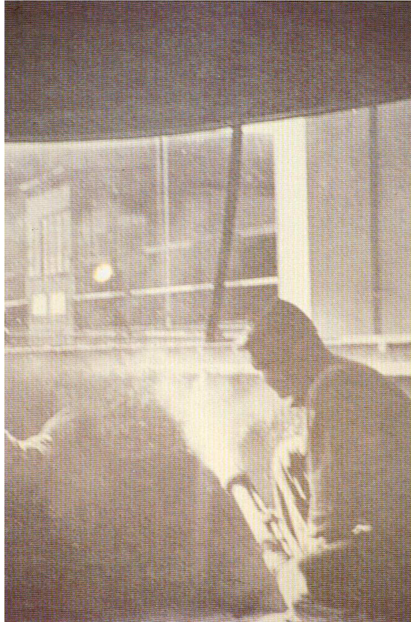
Coibentazione a spruzzo con amianto crocidolite, costruzione di motrice ferroviaria, anni '70.
