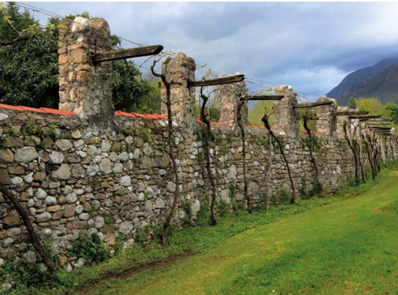
Artegna: un esempio classico di pergolato di vite, ottenuto infilando sostegni orizzontali negli occhielli dei merli; qui la pergola che si ottiene viene detta cjangnele .
