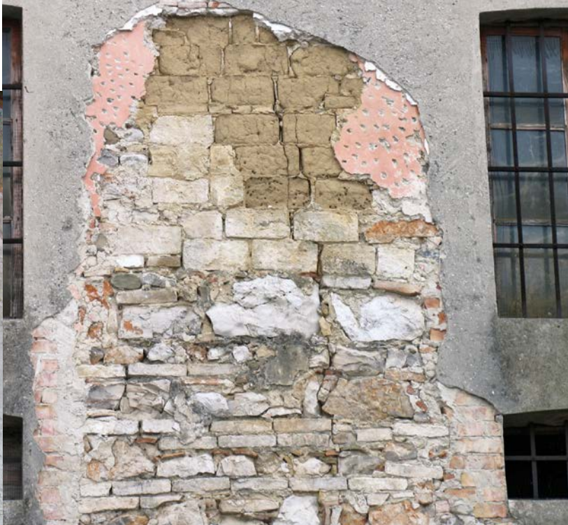
San Vito al Torre, caseggiato in via Roma con un particolare della parete dove, dopo il distacco accidentale dell'intonaco con un affresco votivo, si vedono alcuni mattoni in terra contraddistinti dal colore più scuro (foto Fiappo).
