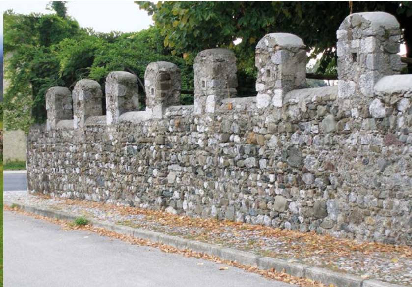
Moruzzo: una fila di merlètis rifinite a testa tonda. Sono state restaurate dal proprietario con l'utilizzo di materiali conformi.
