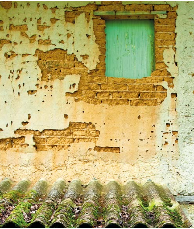
Savorgnano del Torre, casa Squalisse - Roberti, particolare della parete nord prima del restauro: i mattoni in terra e l'intonaco sono stati erosi dalle intemperie (foto Fiappo).
