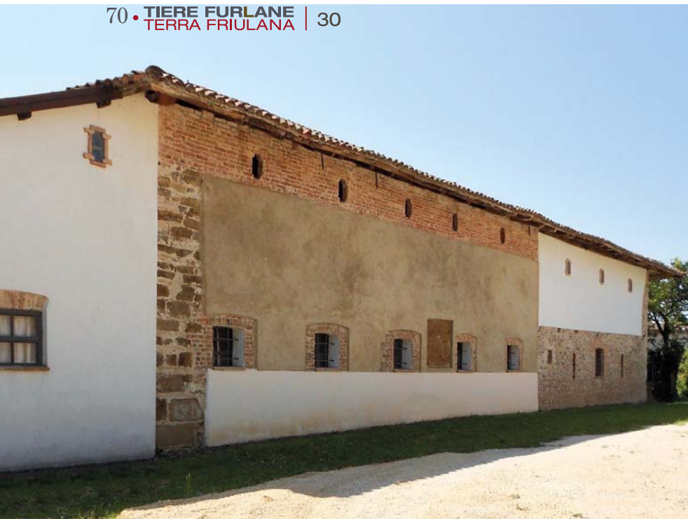
La parete nord di casa Filaferro a Lumignacco dopo i restauri: al centro la zona con il nuovo intonaco in terra (foto Ganis).
