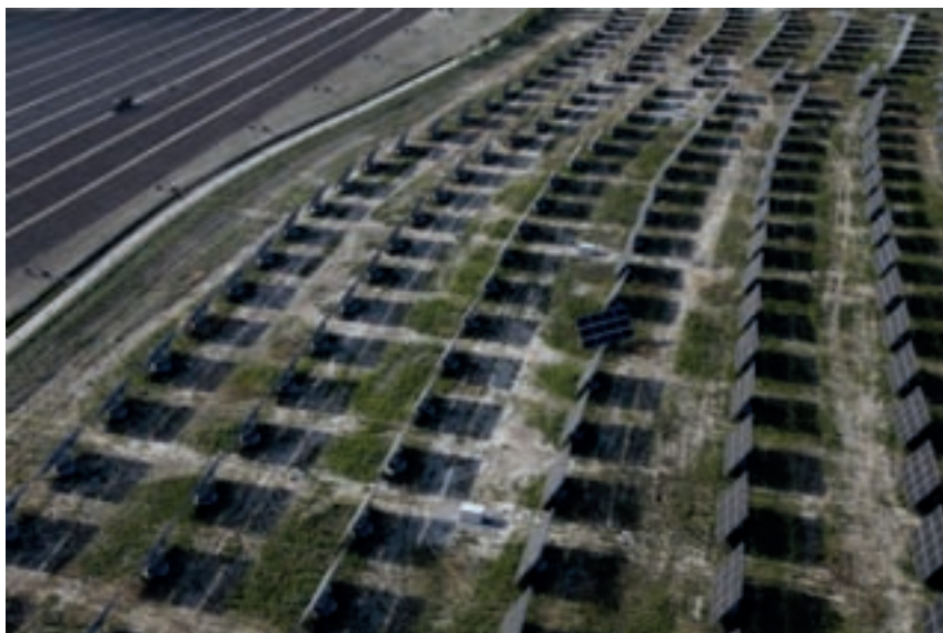
Impianto di pannelli fotovoltaici a terra nella zona di Varmo. Fotografia di Stefano Zanini.
