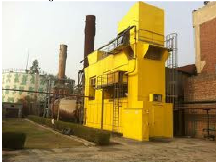
Fig. 01. Tipica installazione dell'impianto di cogenerazione.
