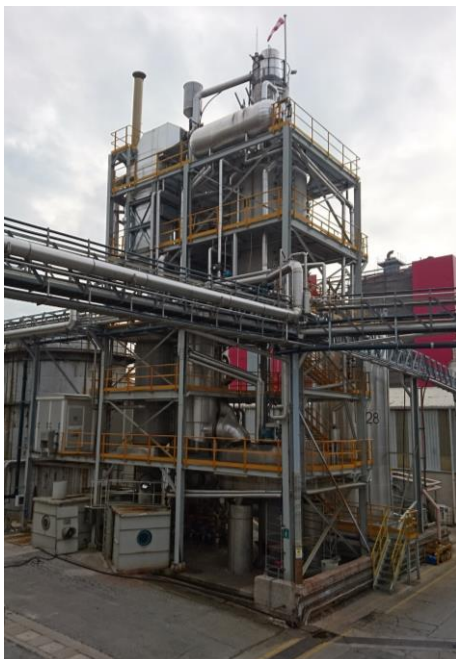
Impianto di produzione formaldeide
