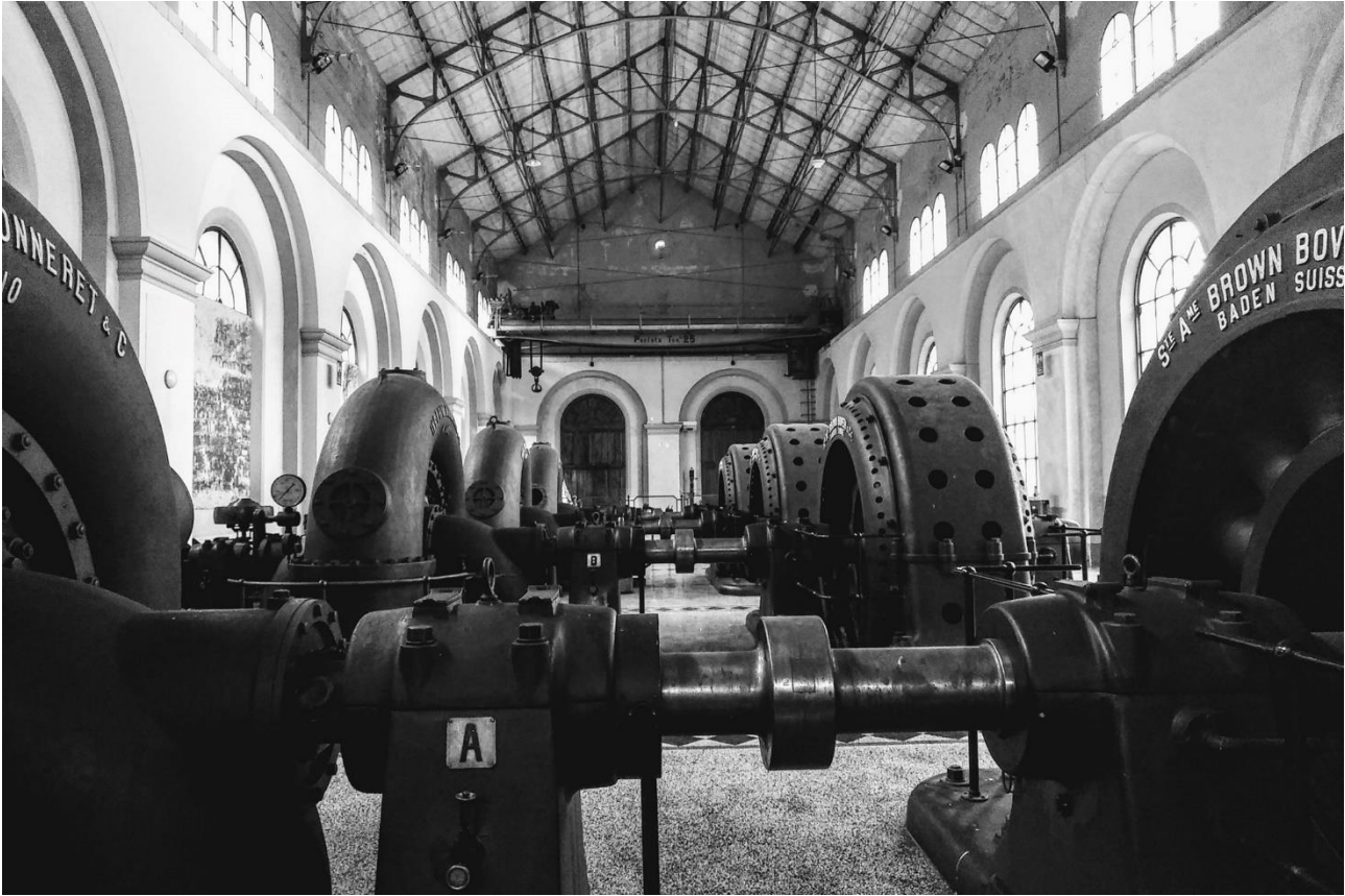
Centrale Pitter di Malniso (Montereale Valcellina)
